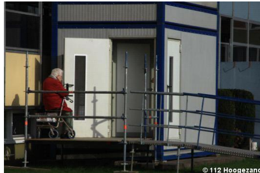
foto tijdelijke lift
